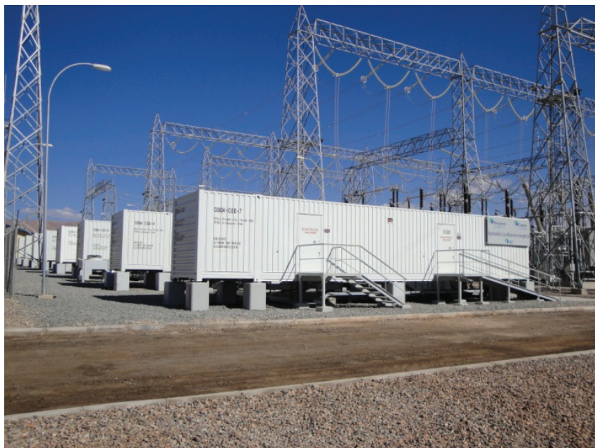
AES Gener 20MW Los Andes BESS in Northern Chile's Atacama Desert
